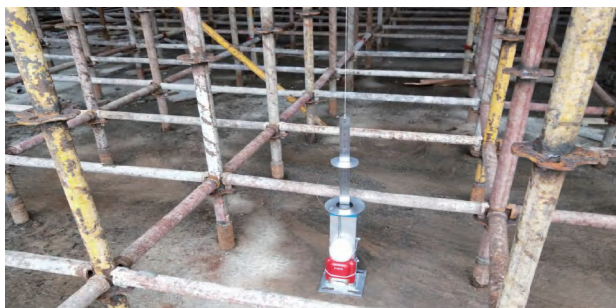
图 5.3.2-1 内支撑脚手架变形智能监测、报警装置的现场应用
